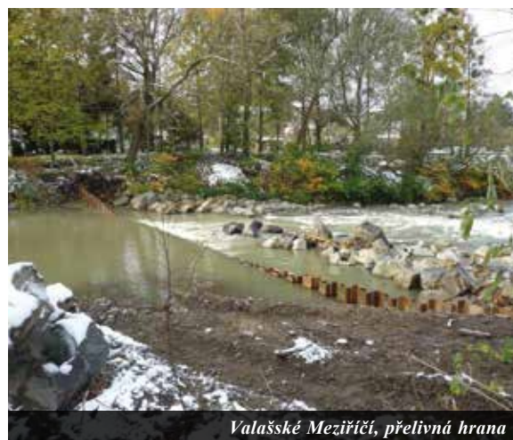
Prostřední Bečva, opravená přelivná plocha
