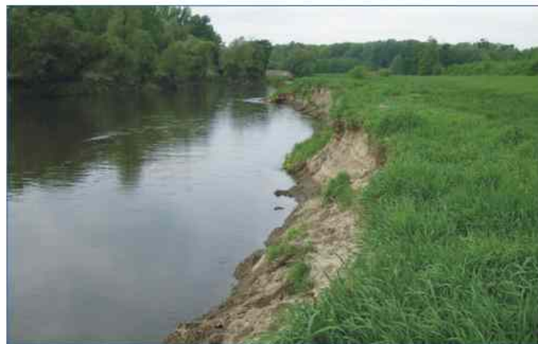
Pravobřežní nátrž na řece Moravě nad soutokem s Dyjí
