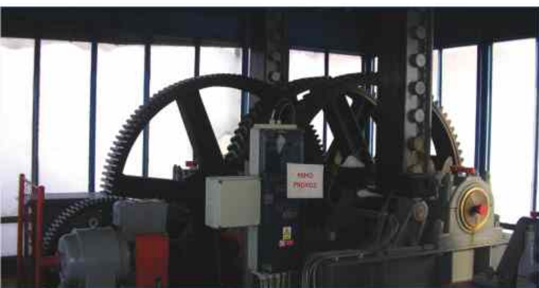
VD Vranov - pohony opravovaného zařízení
