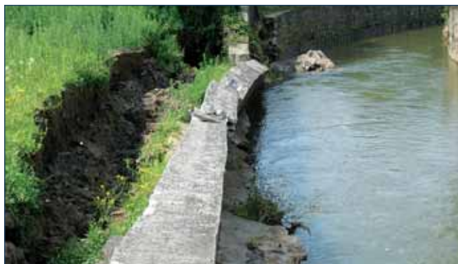
Poškozená zeď na Veličce v Hranicích
