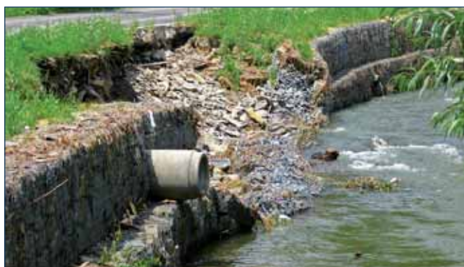
Poškozené drátokoše na Veličce ve Lhotce u Hranic
