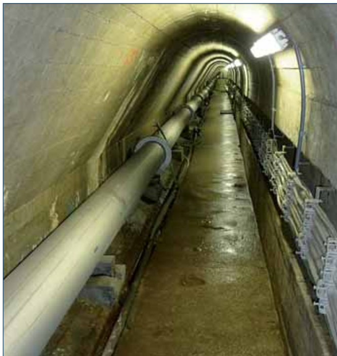
Nerezové vodárenské potrubí osazené v roce 2003
