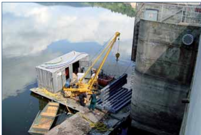
Instalace brazení před spodní výpust za účelem zabránění možného ucpání
