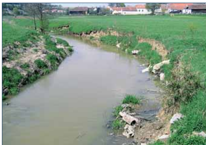
Jedna z mnoha břehových nátrží na Želetavce v Bačkovicích
