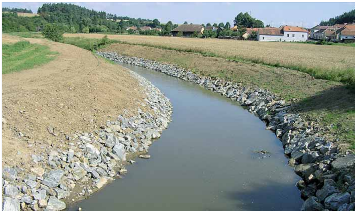
...nátrže po opravě
