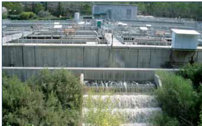
Čistírna odpadních vod v Jeruzalémě
