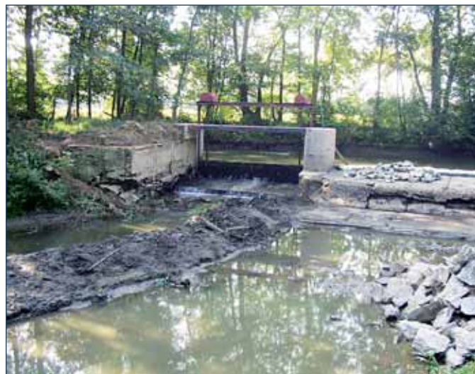
Jez Unčovice na Malé Vodě před opravou
