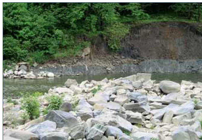
Narušený levý břeh po povodni
