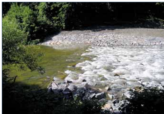
Stupeň po opravě v červnu 2009
