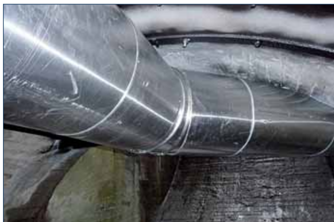
Vodárenské potrubí na VD Ludkovice
