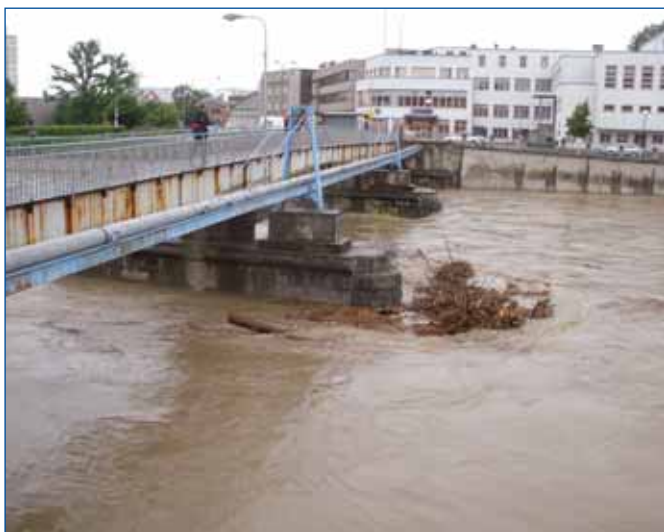
Tok Bečva, Přerov - hromadění plavenin na pilířích mostů průběžně odstraňováno těžkým jeřábem
