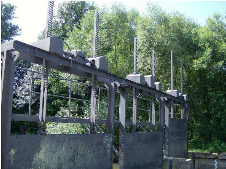
Chybějící kryty na levém a pravém jezovém poli
