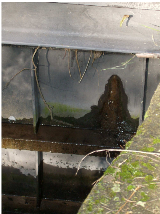
Místo poškození – průsaku v levém stavidlu
