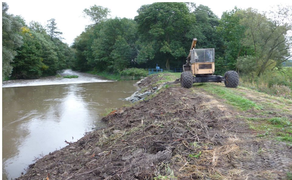
Hráz Rájec, opakovaně poškozovaná Bobrem evropským (Castor fiber) po vytrhání pařezů, zajištění svahu a paty hráze.
