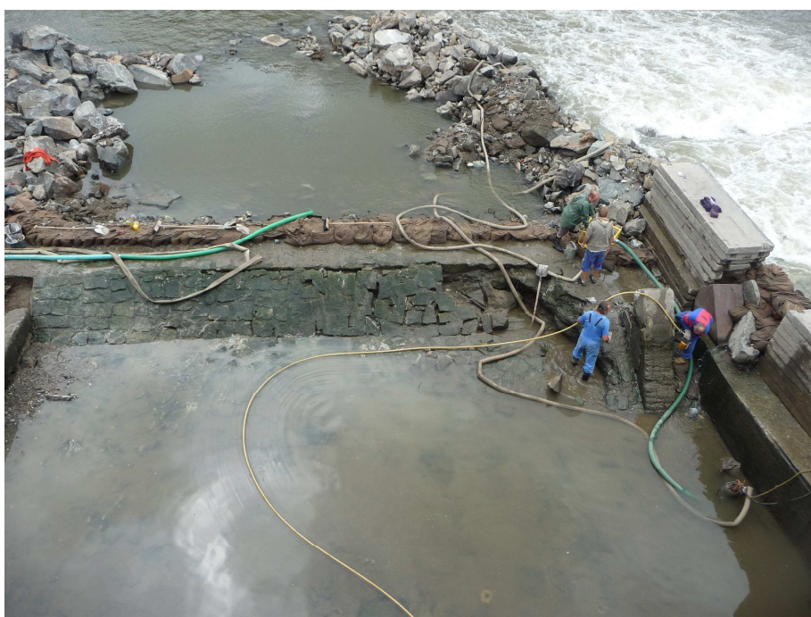
Pohled z jezové lávky do jímky pod klapkami. Čerpání a příprava sanace rozsáhlého výmolu v pravém rohu vývařiště
