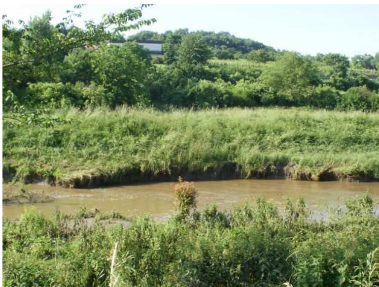
Poškozená pata hráze při opadávajícím povodňovém průtoku
