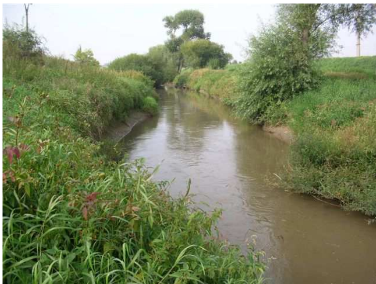
Poškozená pata hráze u ČOV
