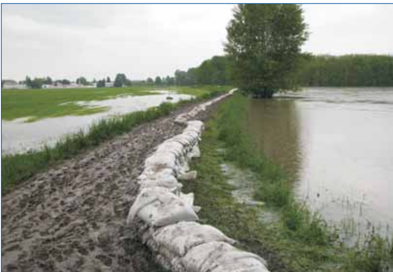
Destruovaná koruna hráze při opadávání povodně
