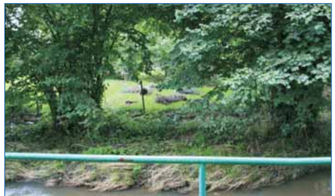
Stržený drátěný plot v záplavovém území toku Bystrá v Markvartících. Při průchodu povodně byl plot překážkou, na které se, jak stále patrně, zachytily plaveniny. Při prohlídce po povodni dne 26. srpna 2010 byl plot ještě stále vztyčený a byla na něm patrná úroveň dosažené povodňové hladiny, odhadem cca 1 až 1,2 m nad terénem.
